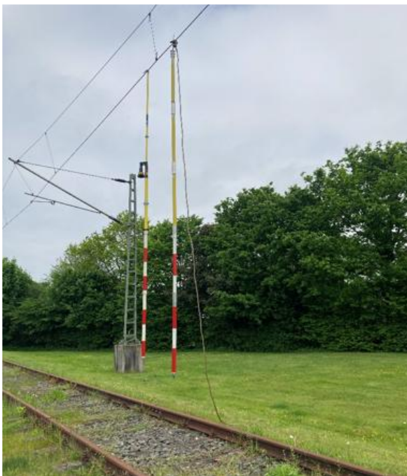
Erdung einer Oberleitung auf einer Ausbildungsanlage
